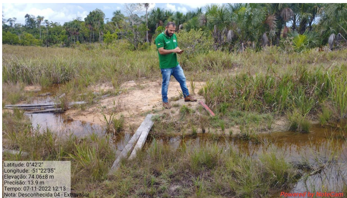
Fotografia 73: Presença de vegetação no vertedouro.
