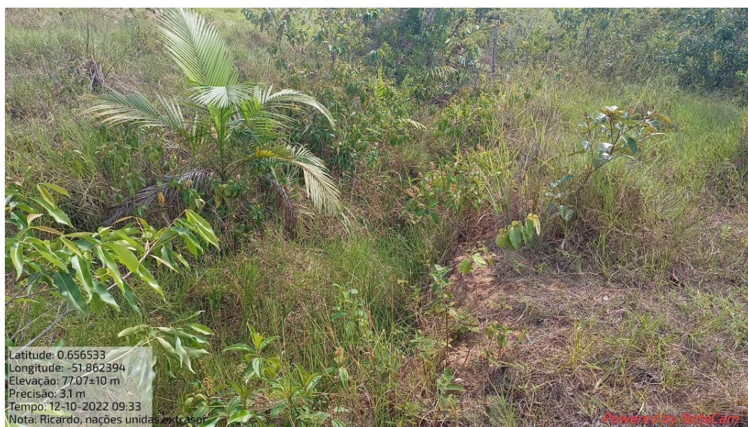
Fotografia 30: Vertedouro obstruído por vegetação.
