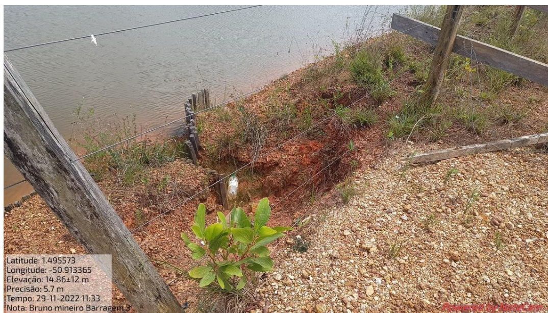
Fotografia 15: Erosão no talude à jusante da Barragem 3.
