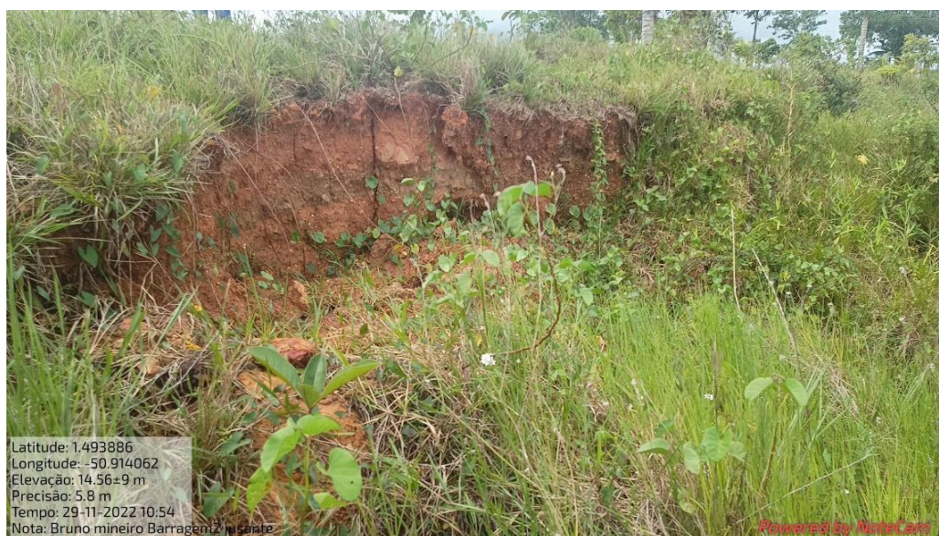
Fotografia 14: Erosão no talude à jusante da Barragem 2.
