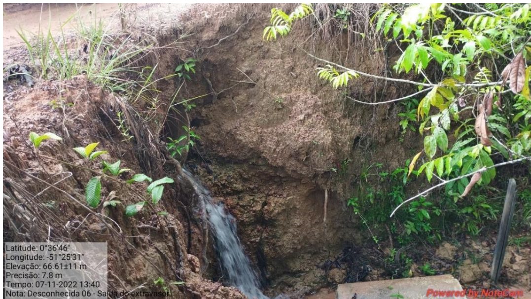
Fotografia 76: Extravasar em tubo de concreto apresenta erosões
