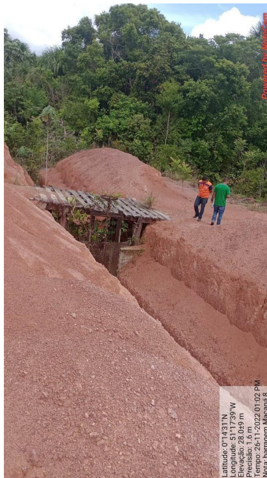
Fotografia 92: Vertedouro, sem proteção, ausência de sinalização.
