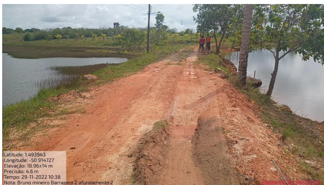
Fotografia 16: Presença de vegetação à montante da Barragem 2.
