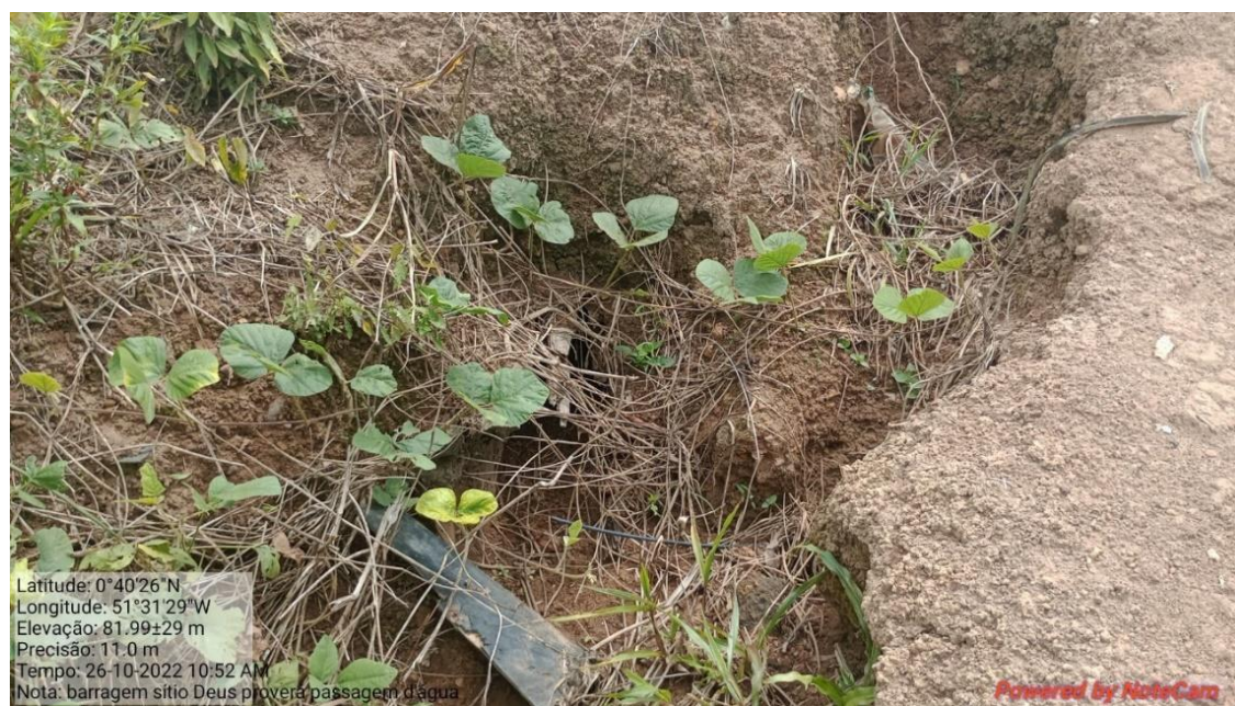
Fotografia 50: Canaleta da barragem Deus Proverá, parcialmente encoberta.
