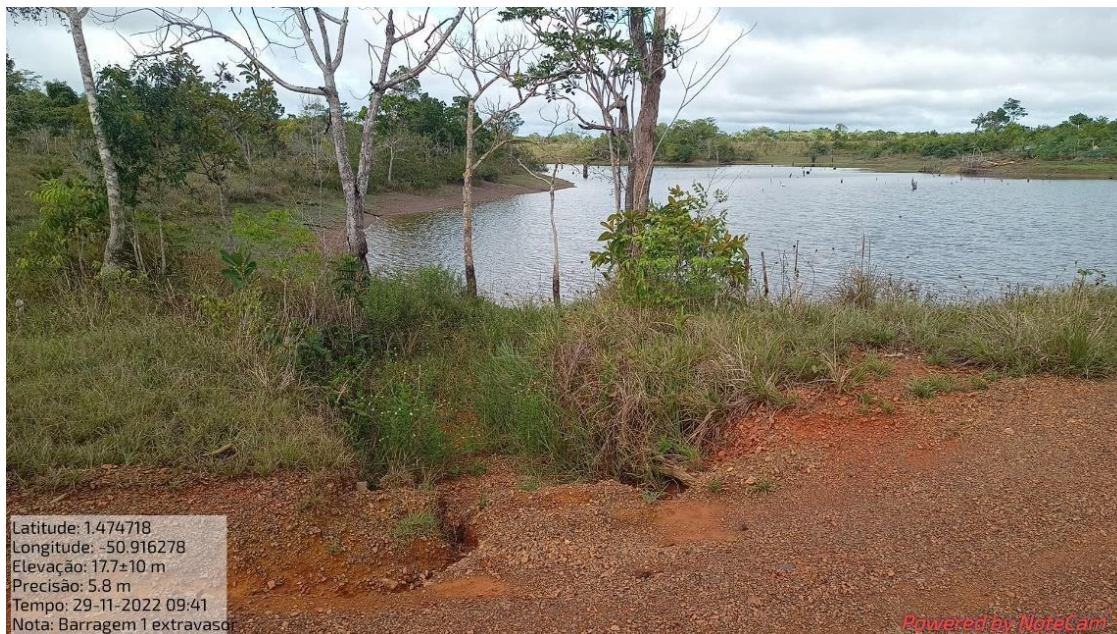
Fotografia 28: Erosão na ombreira direita.
