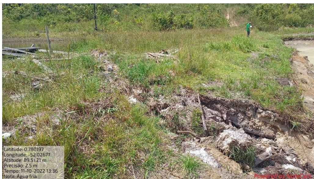
Fotografia 12: Presença de erosão na crista da barragem.
