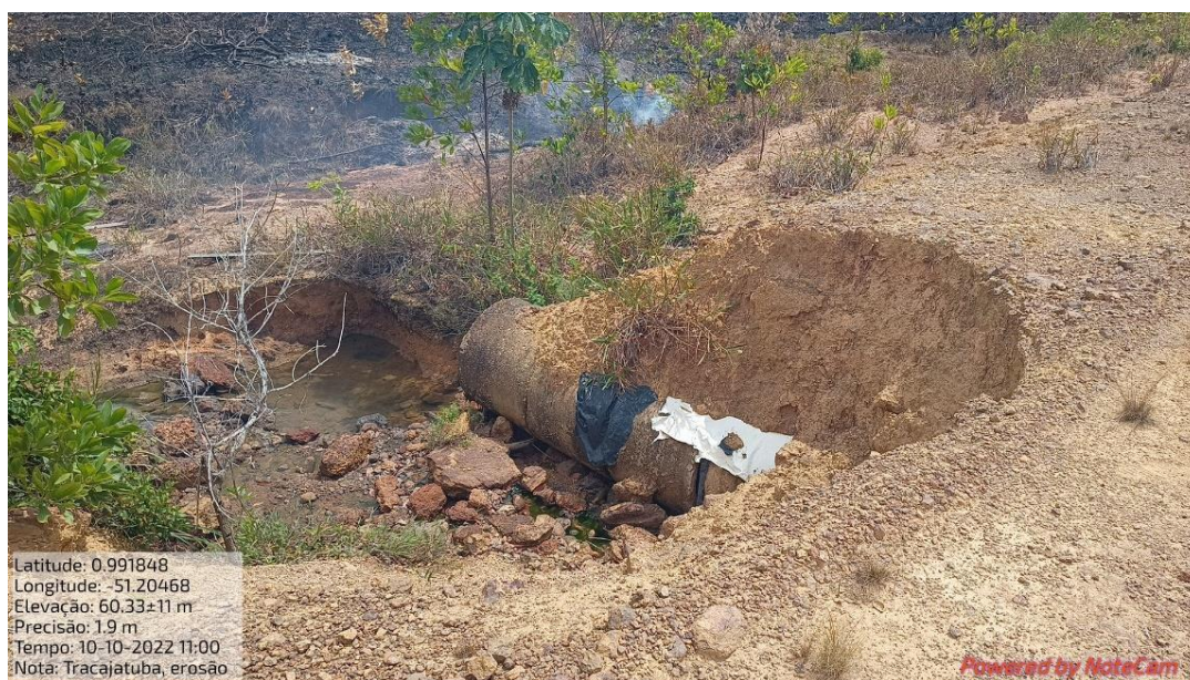
Fotografia 6: Erosão próxima ao vertedouro.
