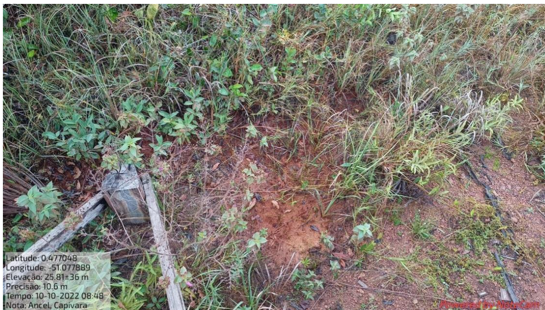
Fotografia 2: Infiltração próximo ao talude de jusante.
