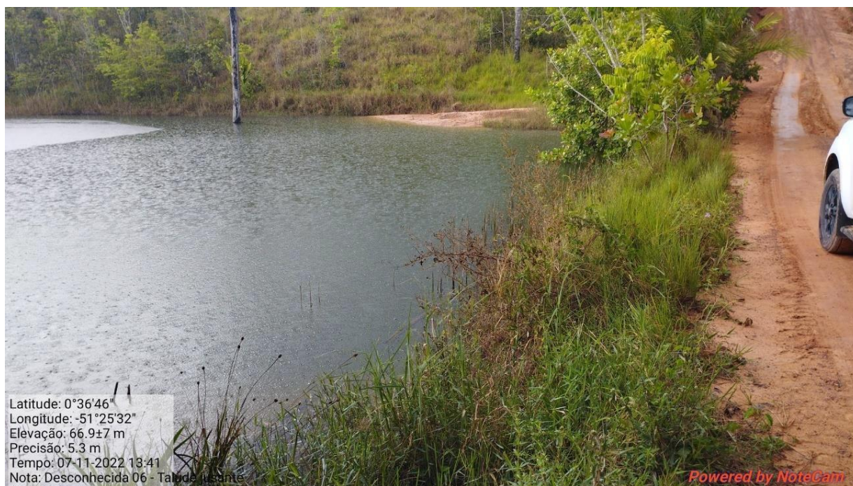
Fotografia 74 - Presença de vegetação no talude montante.
