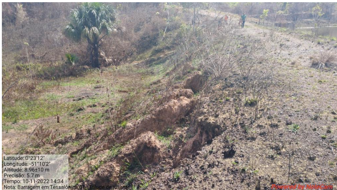
Fotografia 81: Talude jusante com erosões.
