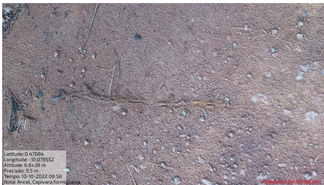
Fotografia 3: Formigueiro na crista.
