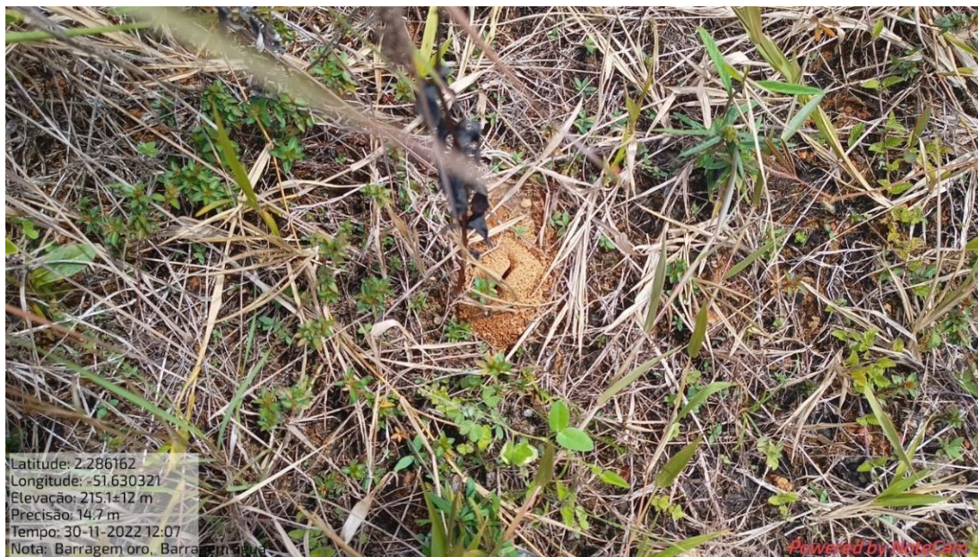
Fotografia 22: Formigueiros na crista da barragem.
