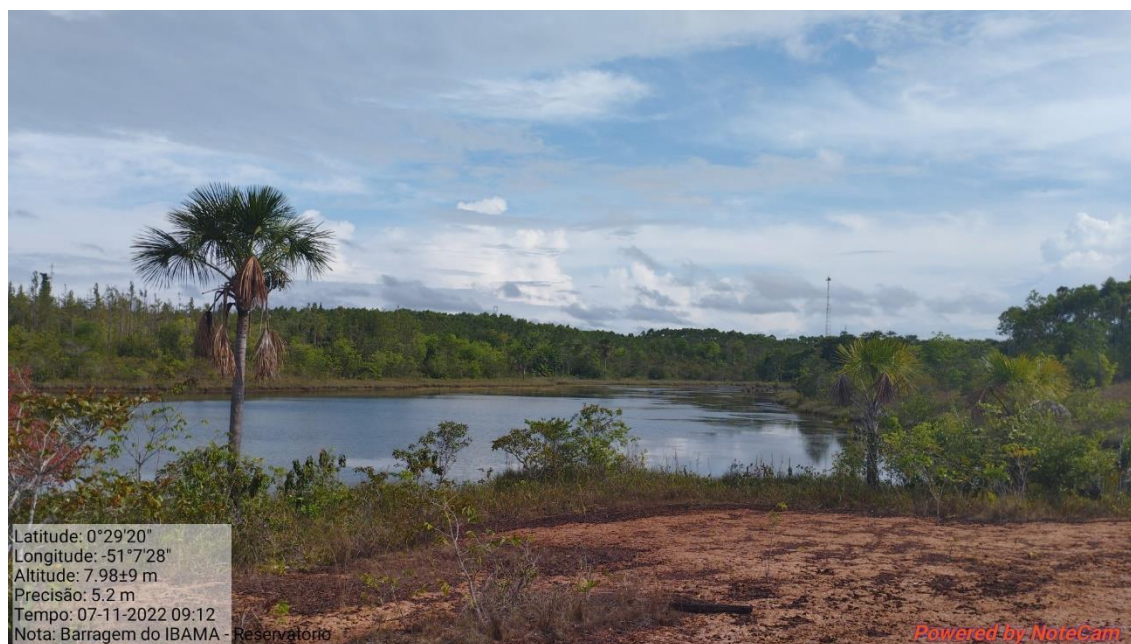
Fotografia 66: Presença de vegetação nos taludes jusante.
