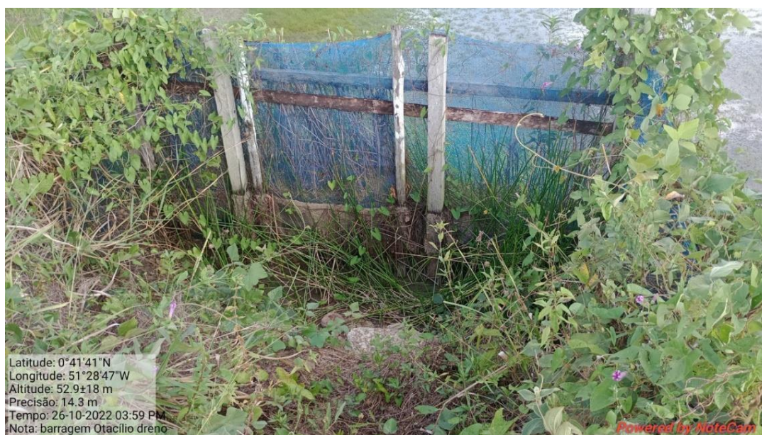
Fotografia 57: Dreno da barragem Nova Esperança.
