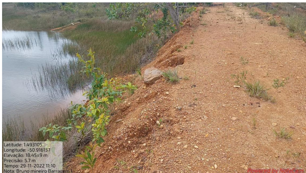
Fotografia 13: Erosão no talude à jusante da Barragem 1.
