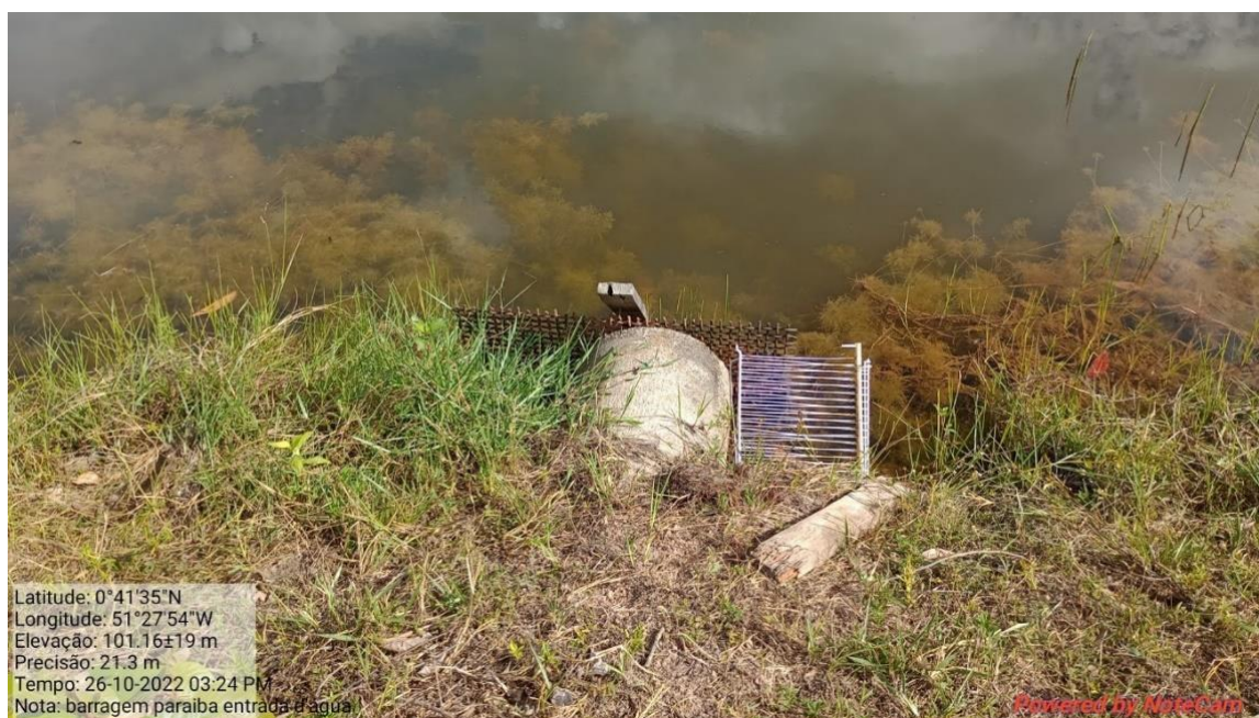
Fotografia 62: Estado do dreno da barragem Paraíba.
