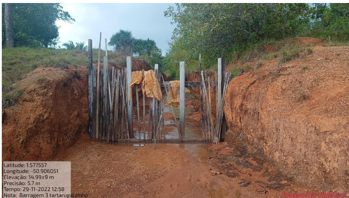
Fotografia 19: Vertedouro alargado sem padrões técnicos.
