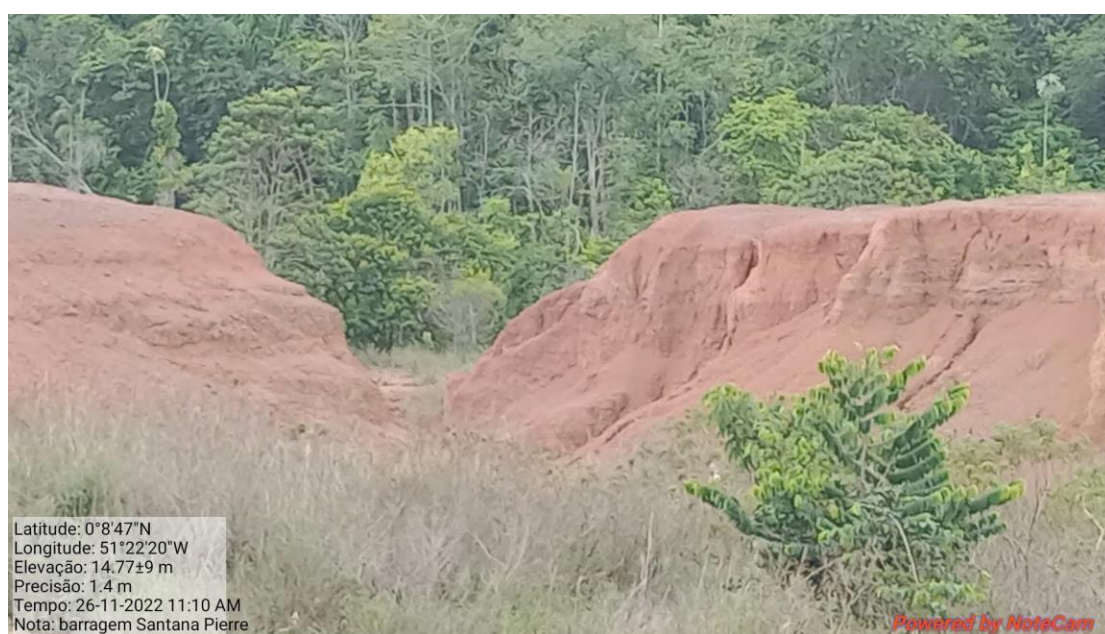
Fotografia 86: Direção à frente do carreamento d'água.
