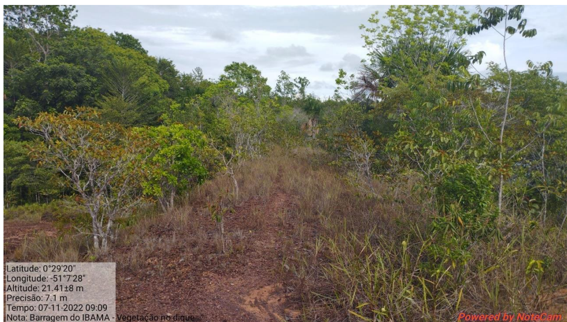
Fotografia 67 - Presença de vegetação nos taludes jusante
