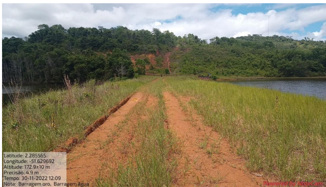
Fotografia 21: Erosão e vegetação na crista da barragem.
