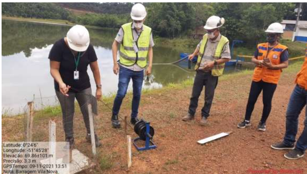
Fotografia 13 - Instrumentação (piezômetro) na barragem.
