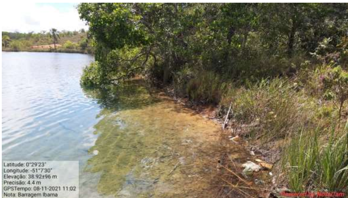
Fotografia 92 - Presença de vegetação de grande porte na crista da barragem.
