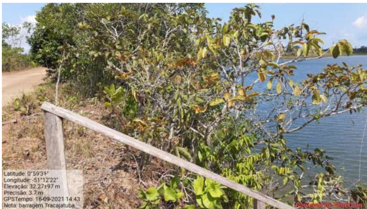
Fotografia 67 - Arbustos no talude de montante.
