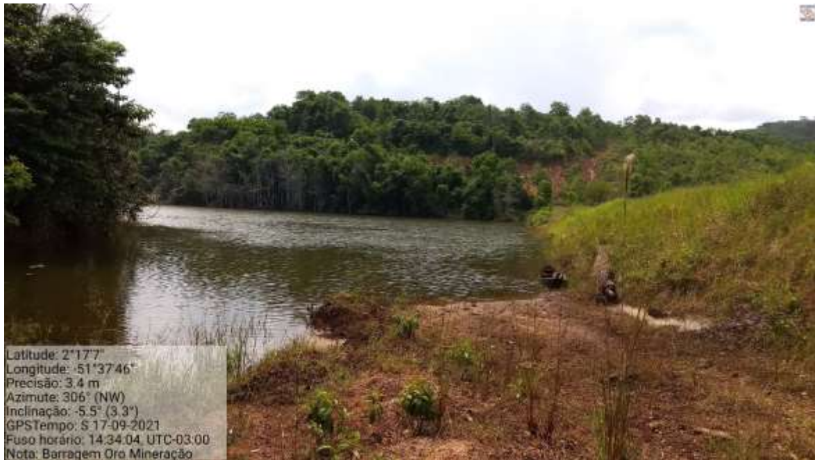
Fotografia 71 - Vegetação e tronco no talude de jusante.
