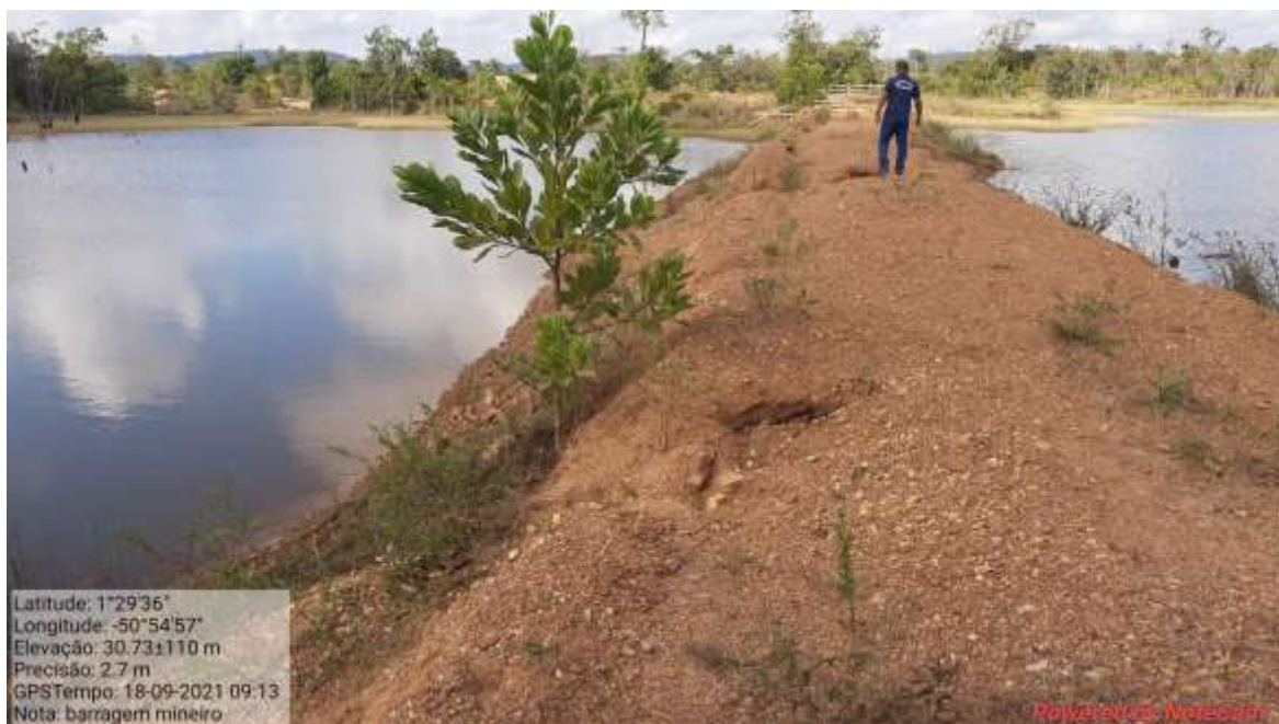
Fotografia 137 - Anomalias nos taludes de montante, jusante e crista da barragem.
