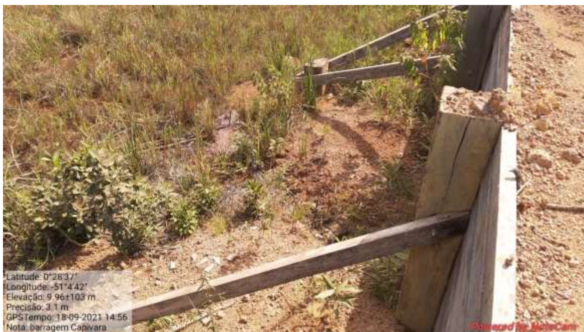
Fotografia 82 - Talude de jusante na vertical.
