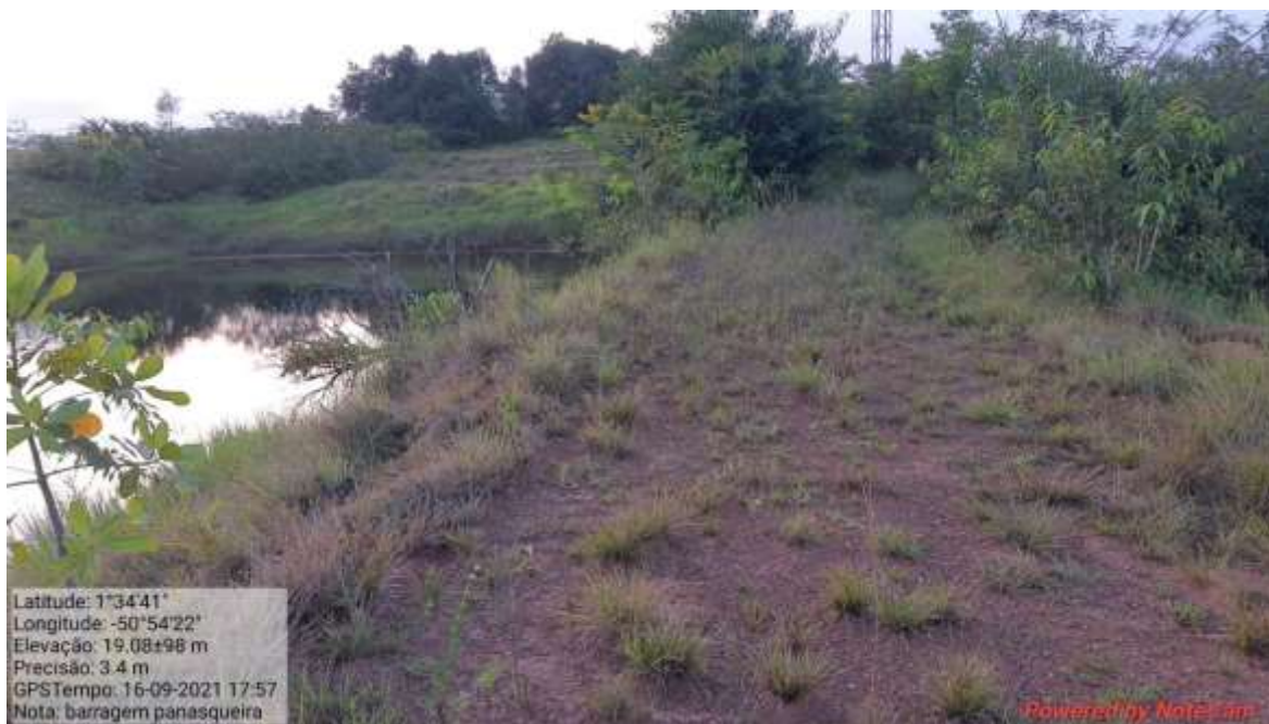
Fotografia 75 - Anomalias visíveis na crista e taludes de montante e jusante.
