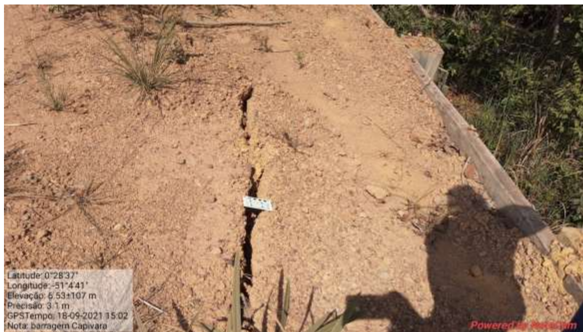
Fotografia 83 - Rachadura na crista da barragem.
