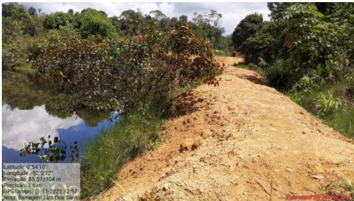
Fotografia 110 - Presença de árvores no talude de montante.
