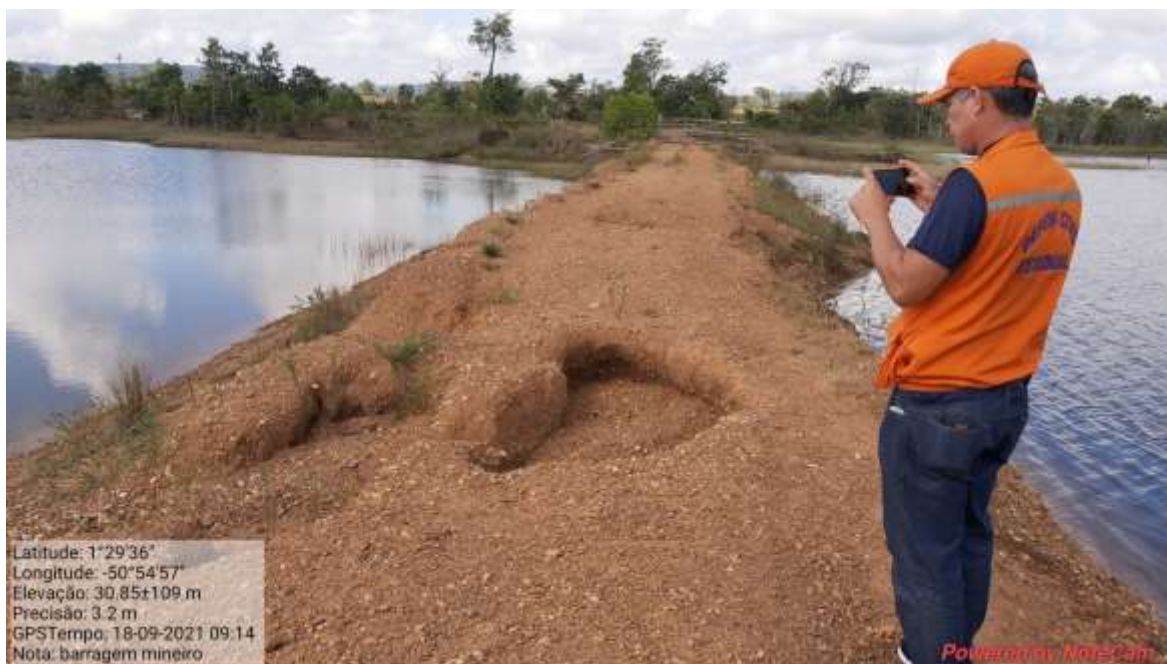
Fotografia 138 - Anomalias na crista da barragem.
