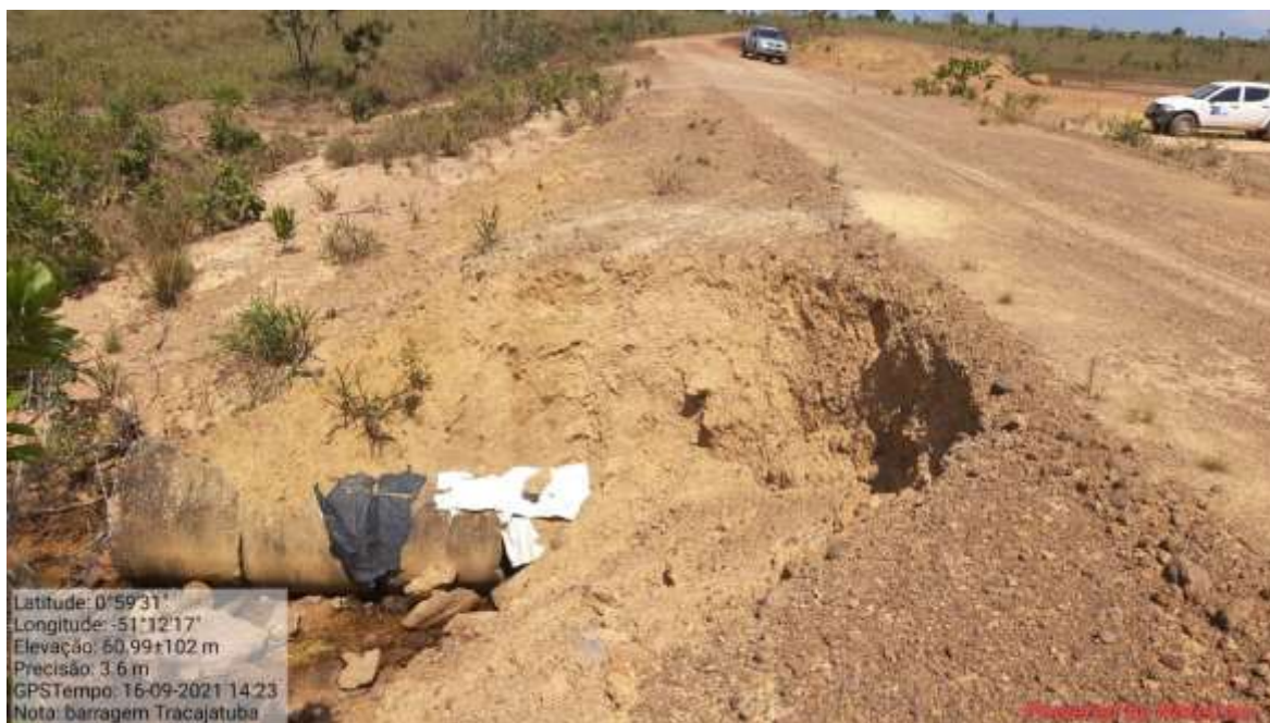
Fotografia 69 - Erosões próximas ao vertedouro.
