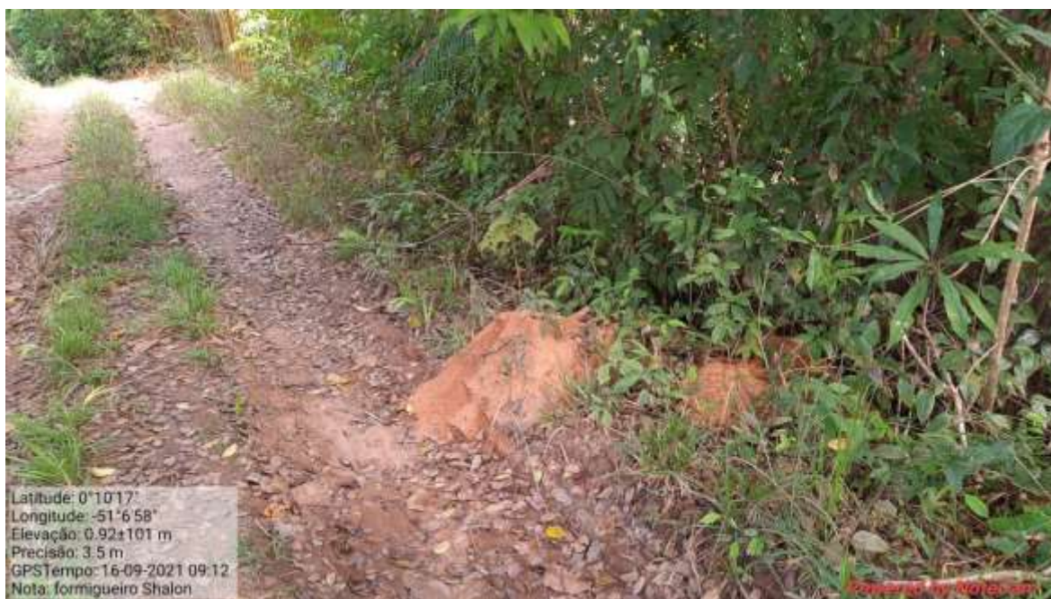
Fotografia 66 - Formigueiros na crista da barragem.
