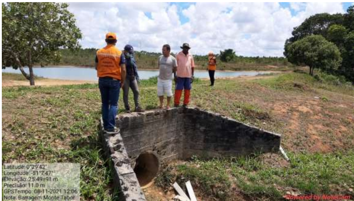
Fotografia 98 - Extravaseiro de concreto (manilha).
