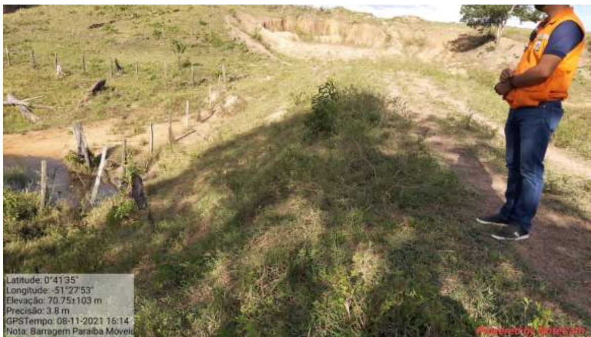
Fotografia 101 - Anomalias no talude de jusante.
