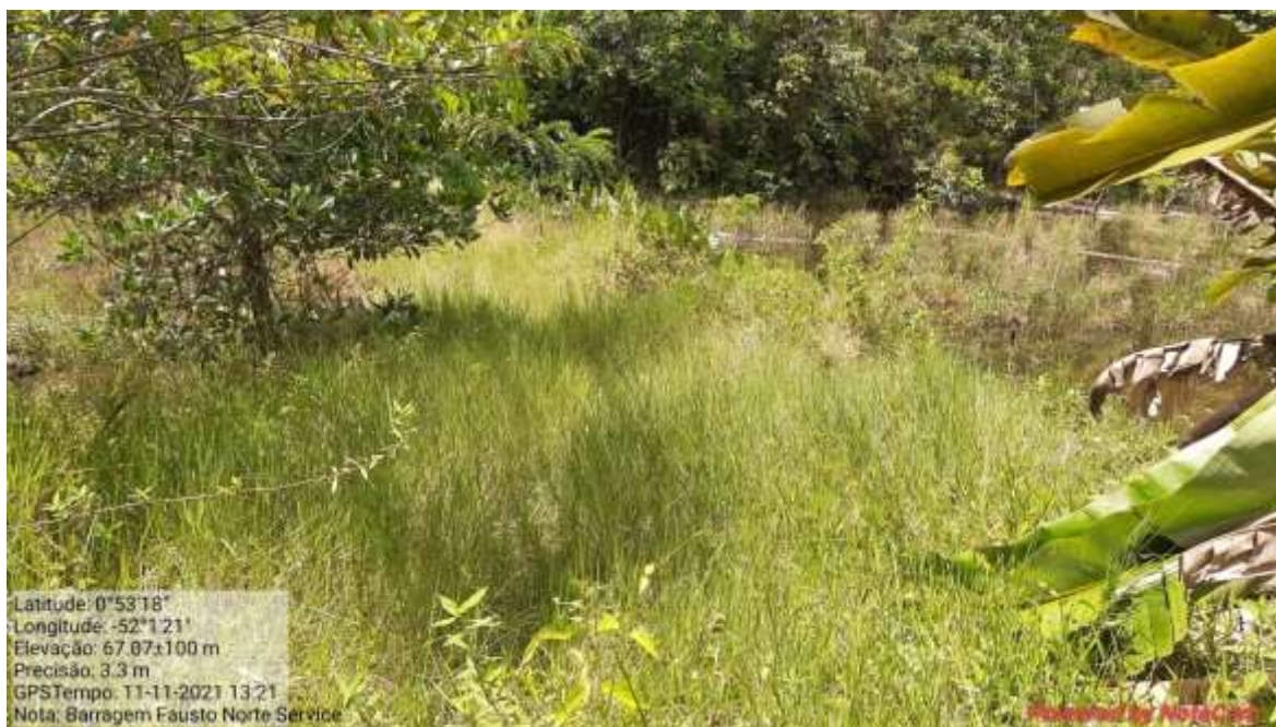
Fotografia 111 - Presença de muita vegetação no corpo da barragem.
