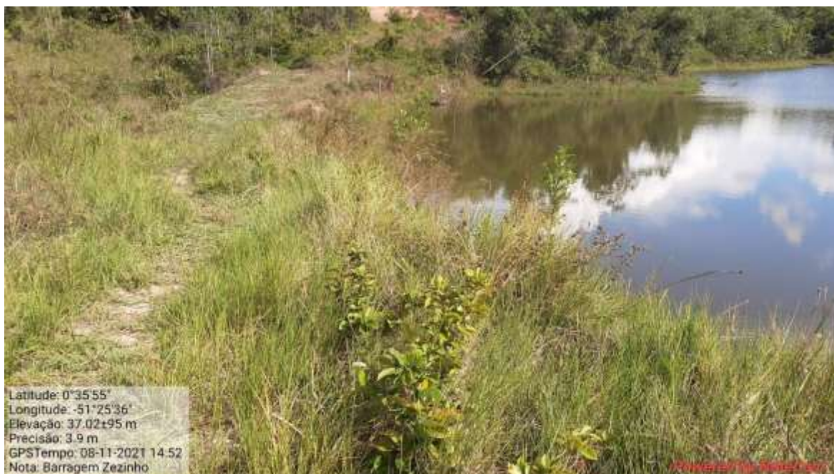
Fotografia 78 - Anomalias presentes nos paramentos da barragem.
