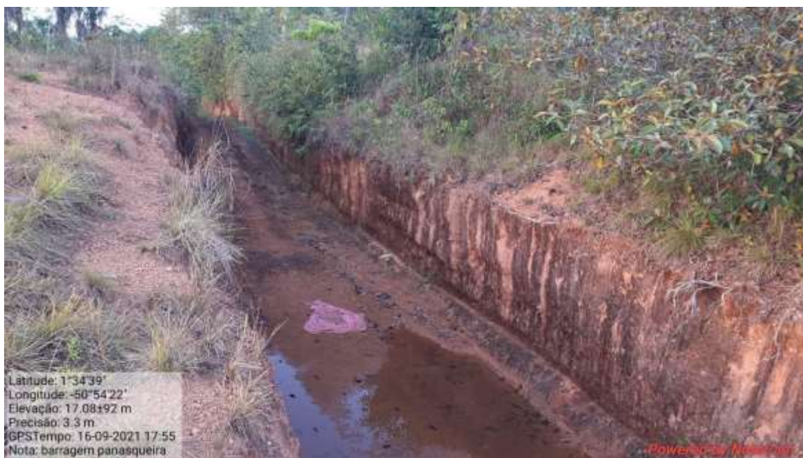
Fotografia 76 - Vertedouro foi alargado e aprofundado.
