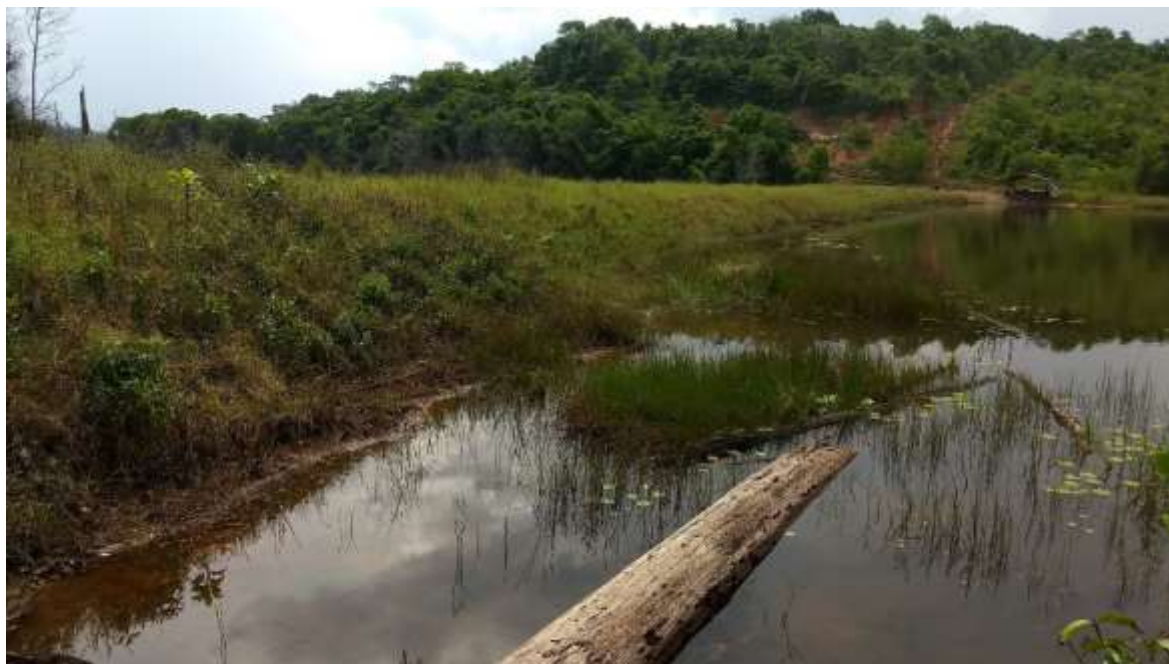
Fotografia 70 - Vegetação e tronco no talude de montante.
