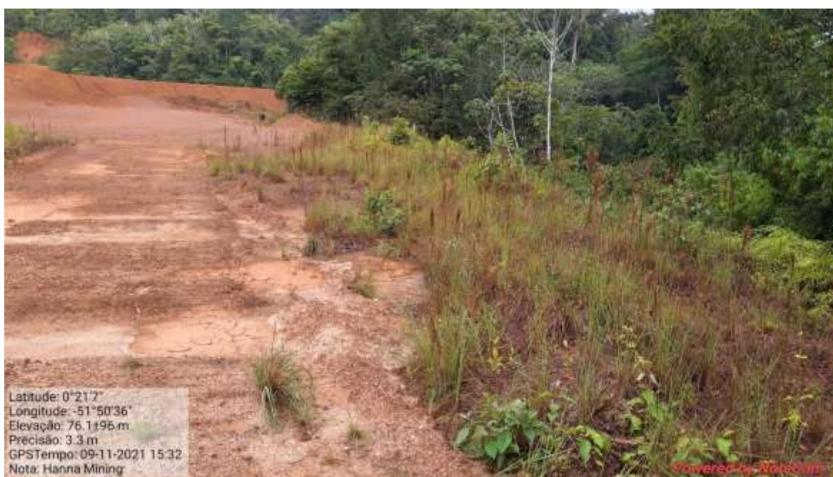
Fotografia 105 - Anomalias no talude de montante.
