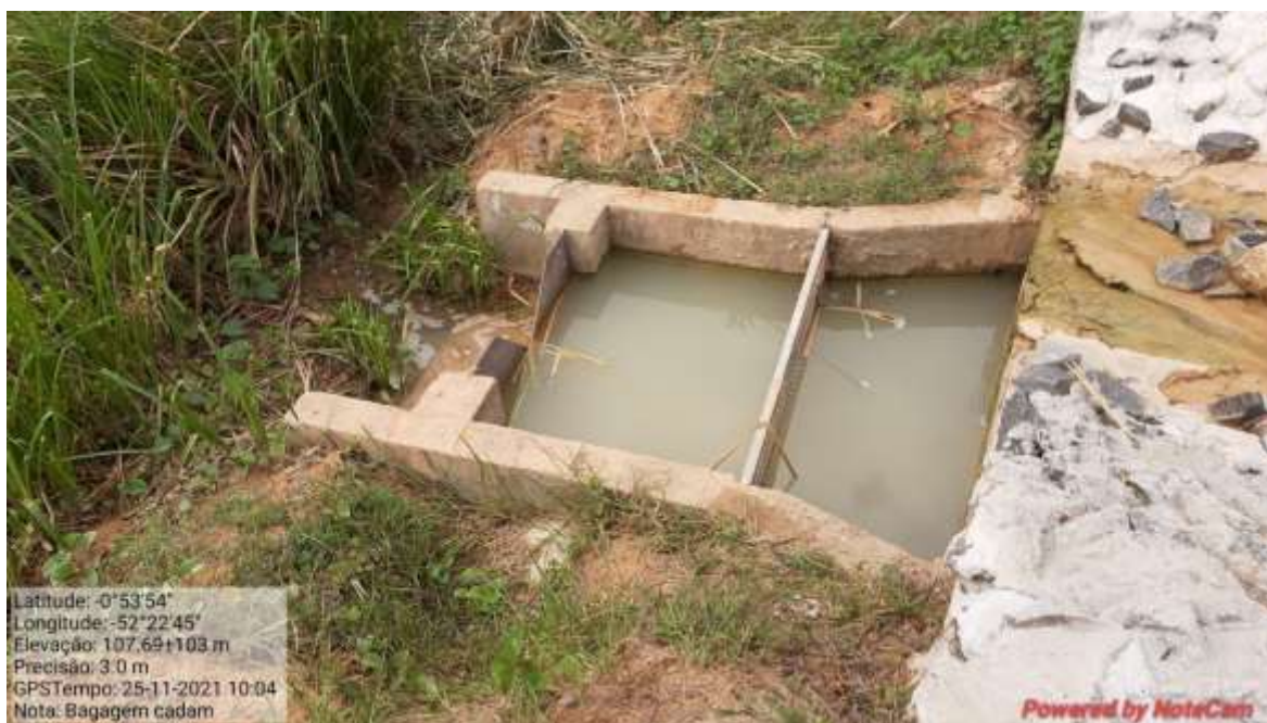
Fotografia 51 - Medidor de vazão (Calha Parschal).
