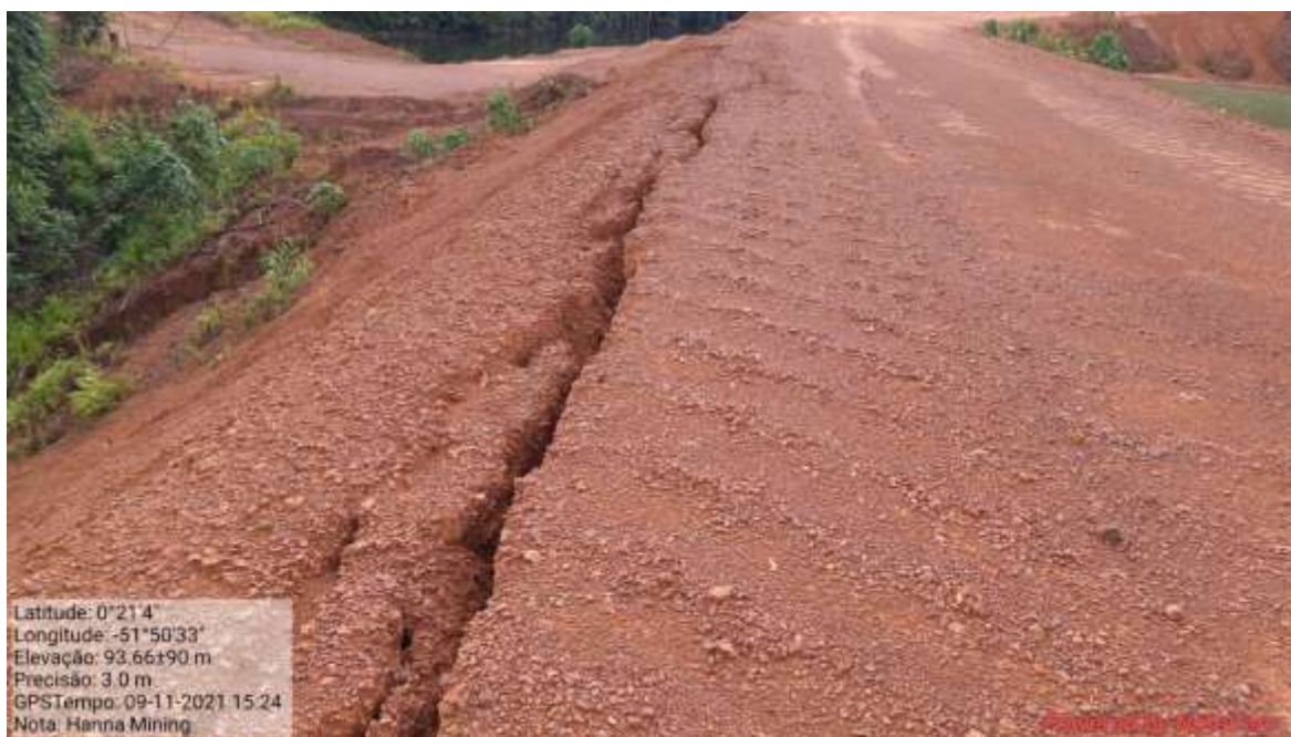
Fotografia 17 - Anomalias como rachaduras e erosões na crista da barragem.
