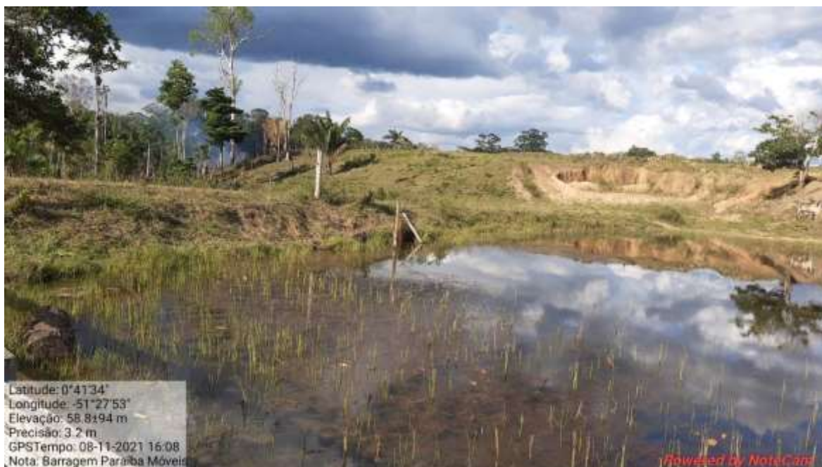
Fotografia 100 - Anomalias no talude de montante.
