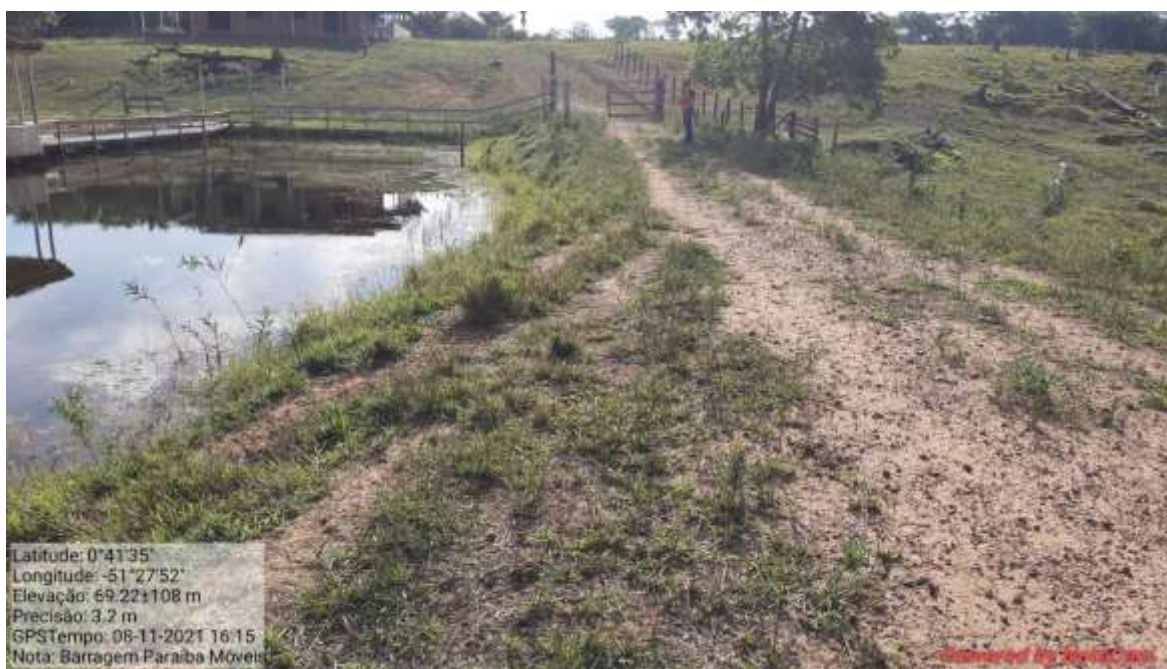
Fotografia 102 - Anomalias na crista da barragem.
