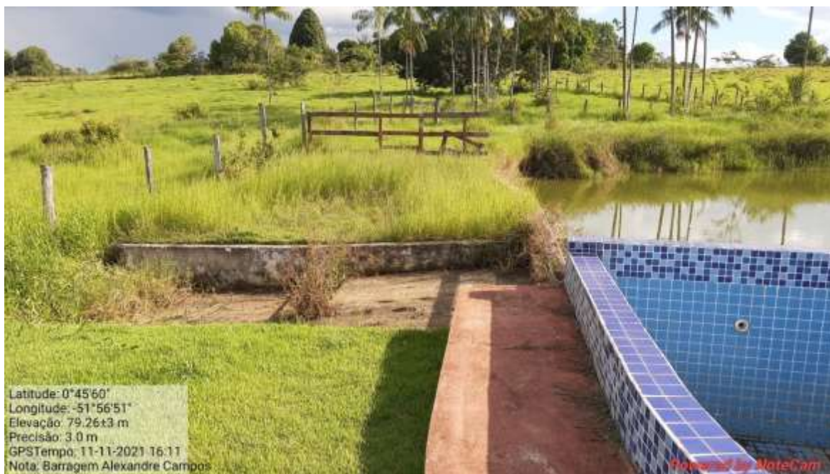
Fotografia 120 - Muita vegetação no corpo da barragem.
