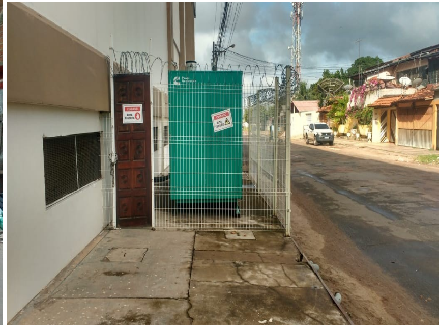
Obstrução do passeio público
